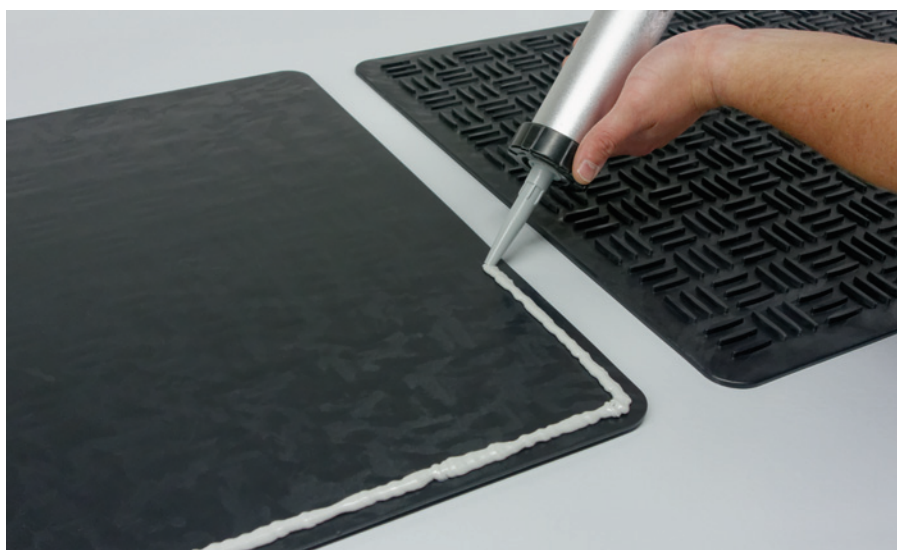
Auftragen des pastösen Kartuschen-Kleb- und Dichtstoffs alwitra-EVATAACK auf der Rückseite der Inspektionswegeplatte.
